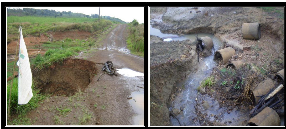
Figura 44: Estrada possivelmente danificada pela ação da chuva e trânsito de veículos pesados. Autora: Colasante, 2009.
