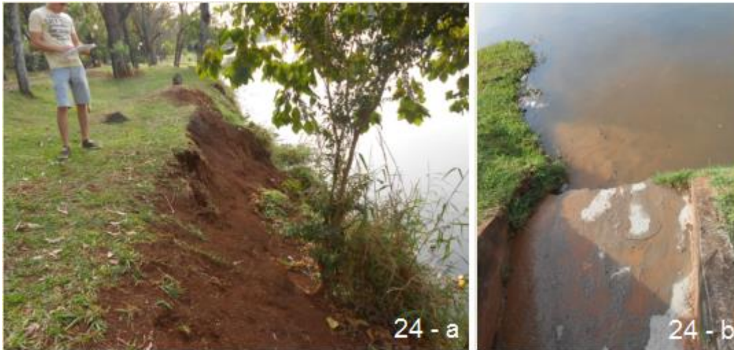
Figura 24 – Erosão na Margem
