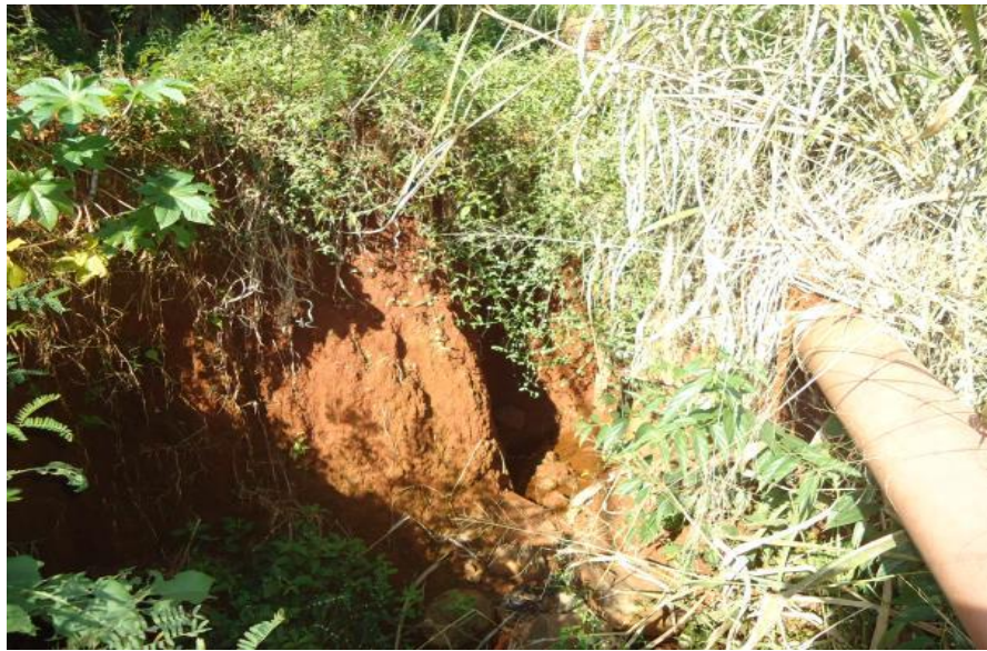
Figura 28 – Processo erosivo Preservação do córrego Tucanos. Fonte: CARDOSO, Priscila M.
