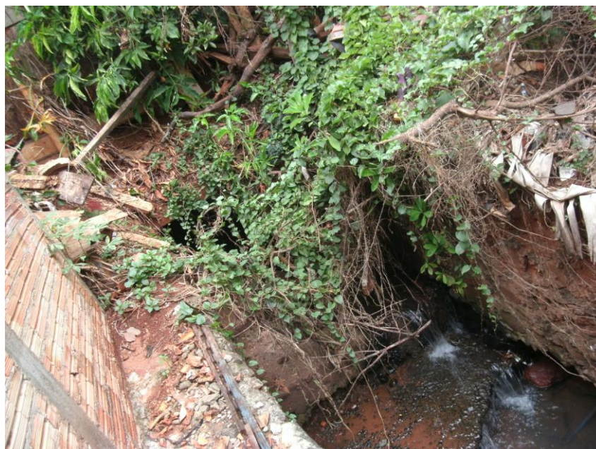
Foto 06: Afloramento da nascente do córrego Londrina. Desrespeito claro a lei n° 1265 de 25/05/12, que, do mesmo modo que a resolução n° 303 do CONAMA, determina como APP um raio mínimo de 50 metros em torno de nascentes e obrigatoriedade de manutenção de mata ciliar, e sua imediata recuperação em caso de degradação. Foto: da autora
