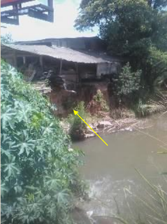
Figura 28: vertente esquerda do Rio Carambeí e Guaçu na Avenida Brasil – residência/borracharia Fonte: Gilberto Chagas - 25/10/11
