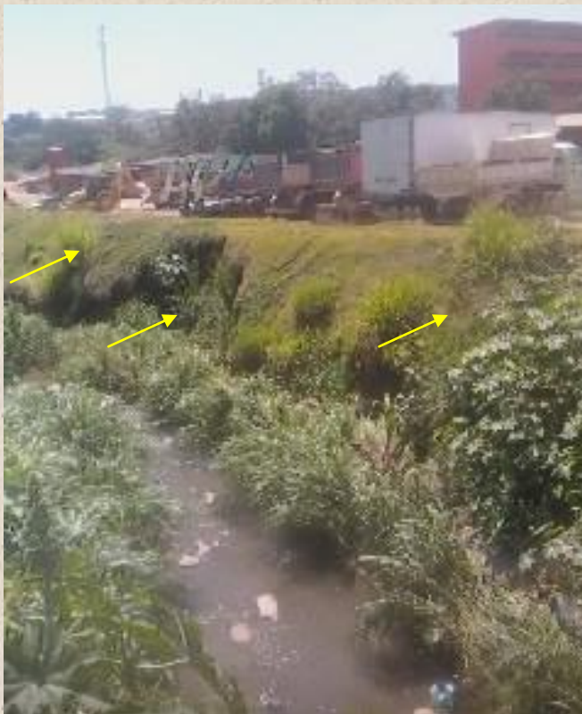
Figura 24: vertente do Rio Marmeleiro – depósito de materiais de construção – erosão e vegetação
