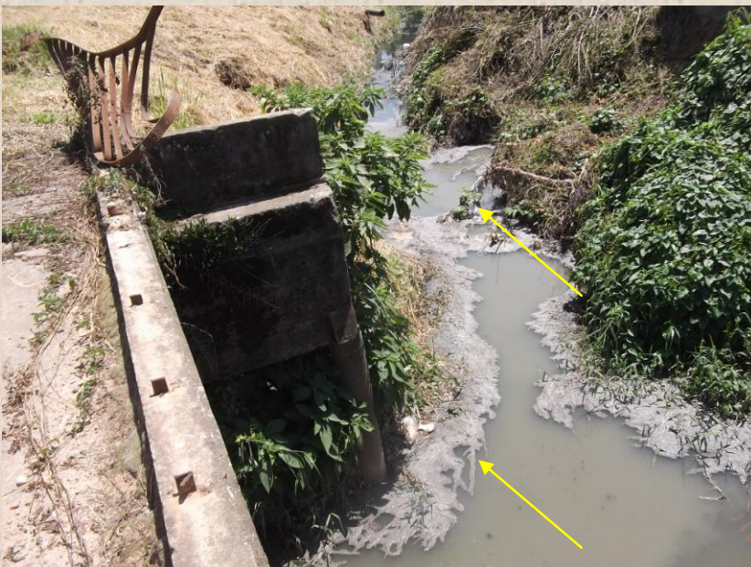
Figura 29: Rio Carambeí na confluência com rio Guaçu – presença de esgotos e lixo. Fonte: Gilberto Chagas- 25/10/11
