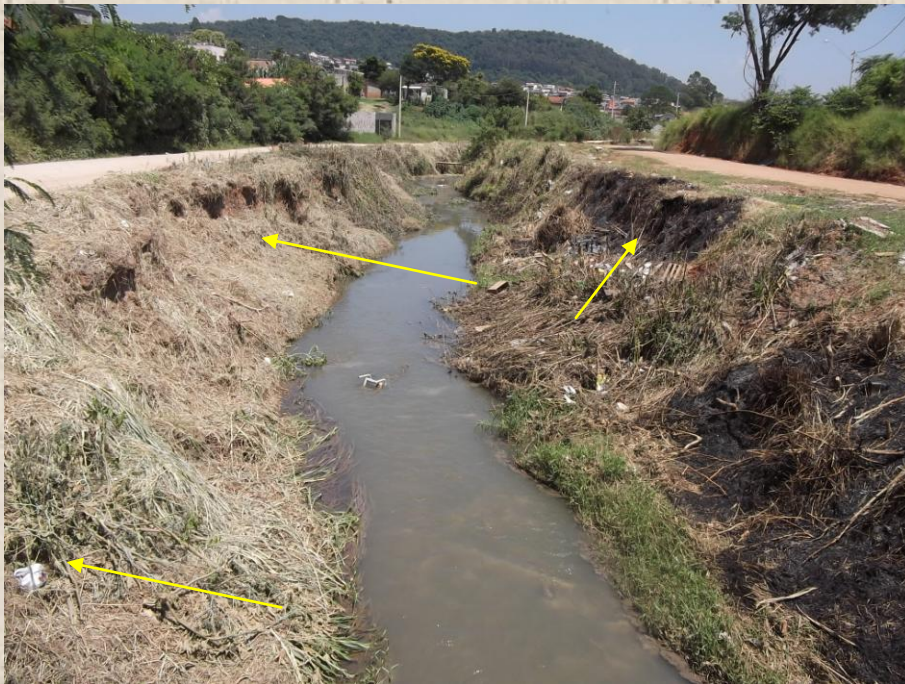
Figura 27: Rio Guaçu – São Roque – pontos de erosão e resíduos espalhados nas margens, ausência de mata ciliar Fonte: Gilberto Chagas - 23/10/11
