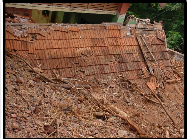
Figura 5 - Usina coberta por detritos.
