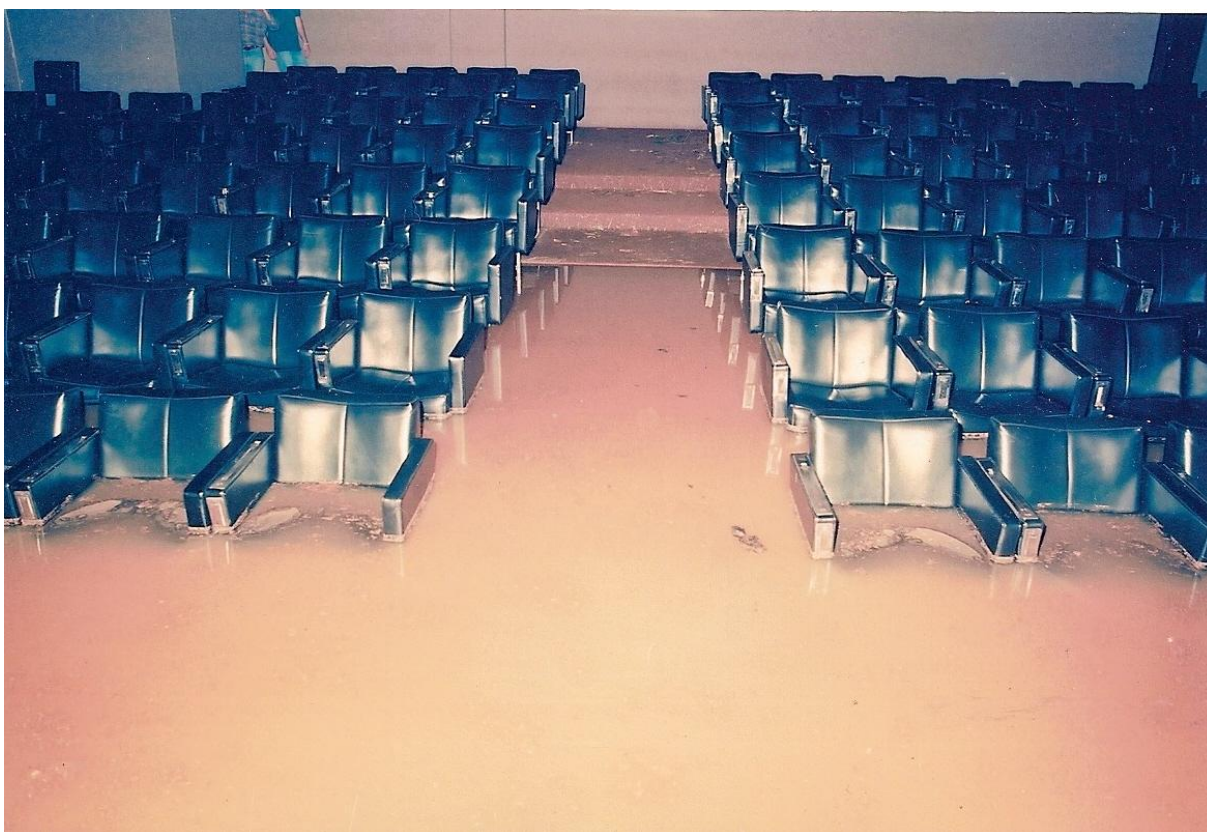
Figura n.º 16. Alagamento do Auditório do Iapar.
